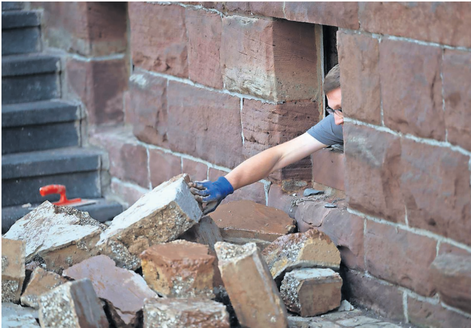
Ein Mann wirft einen Stein aus dem Keller eines Hauses, das vom Hochwasser der Kyll betroffen ist. Vor einigen Tagen waren zahlreiche Häuser in der Region im Bereich Vulkaneifel vom Hochwasser durch den Fluss geflutet worden. Fotos: Harald Tittel (dpa) / DRK-Kreisverband Vulkaneifel
